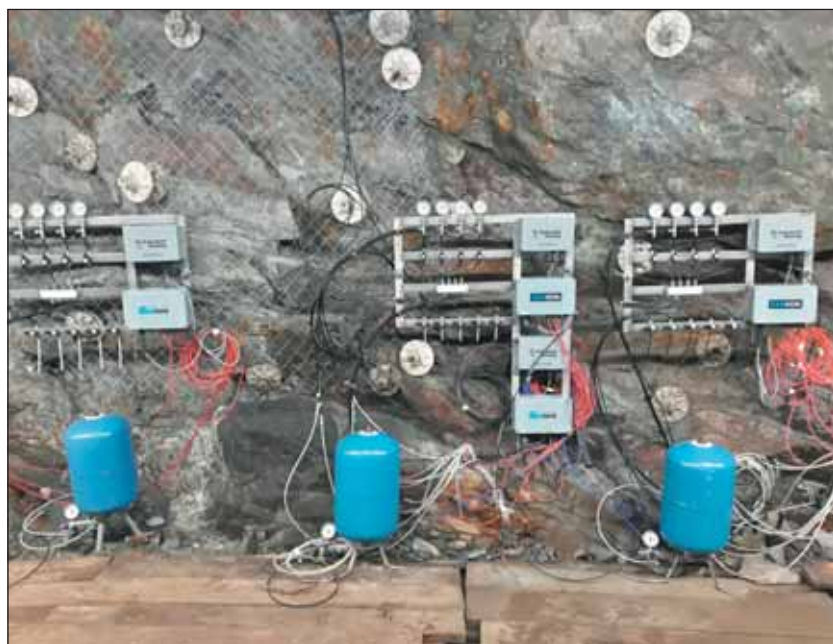
Obr. 6 Kontrolní a ovládací panely multipakrů ve vrtech v PVP Bukov I
