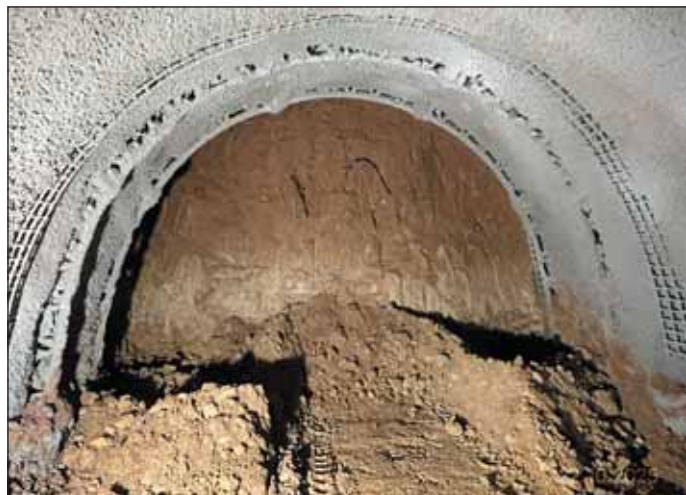
Obr. 5 Nezajištěná čelba výrubu kaloty ze sprašových hlín a rozložených slínovců poblíž TK7
