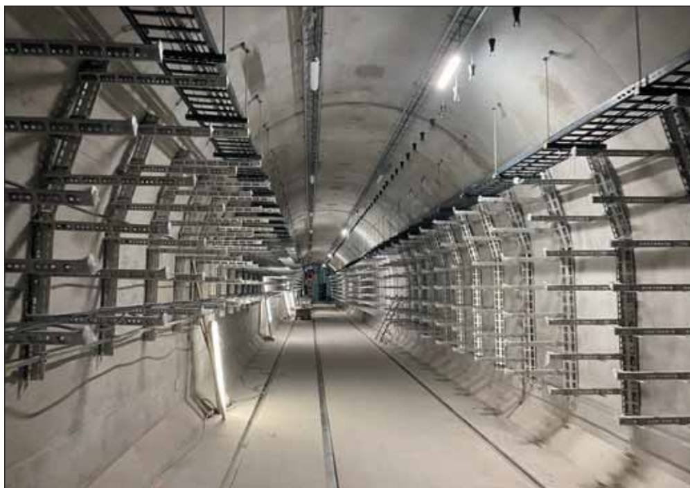
Obr. 14 Instalované kabelové lávky v dokončeném kolektoru Fig. 14 Installed cable trays in the completed utility tunnel
