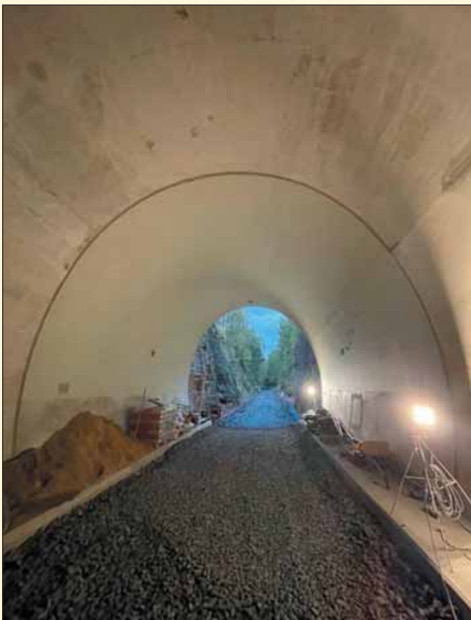
Obr. 5 Dokončená betonáž sekundárního ostění, pohled směr Liberec Fig. 5 Completed secondary lining concreting, view in the direction of Liberec
