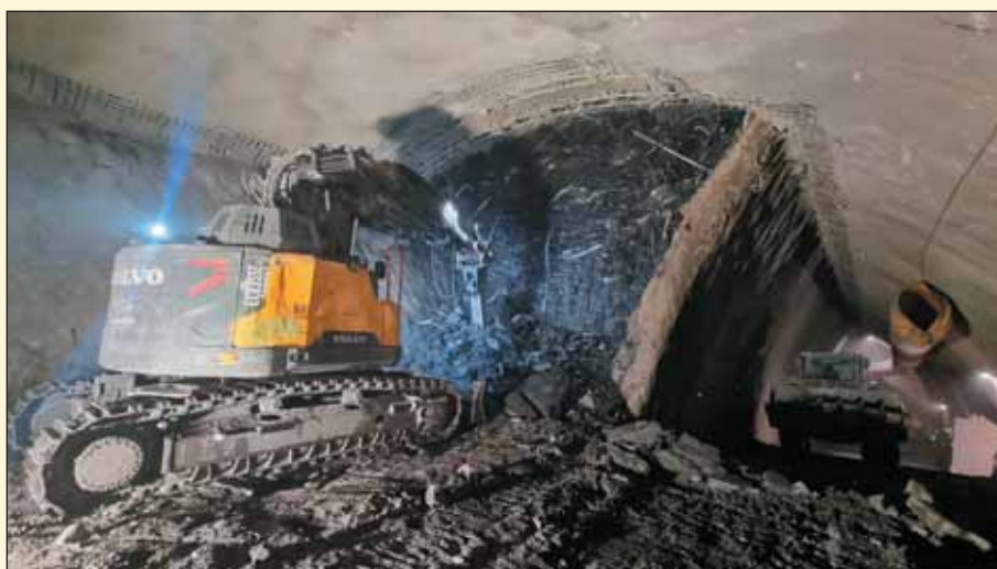
Obr. 2 Ražba středního dílu kaloty stanice Fig. 2 Excavation of the top heading central section of the station
