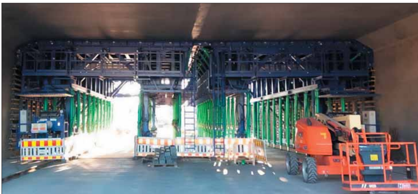
Obr. 6 Zařízení při betonáži tunelu Høvik v rámci projektu modernizace silnice E18 v norském Oslu Fig. 6 The device during concreting of the Høvik tunnel within the E18 road modernisation project in Norwegian Oslo
