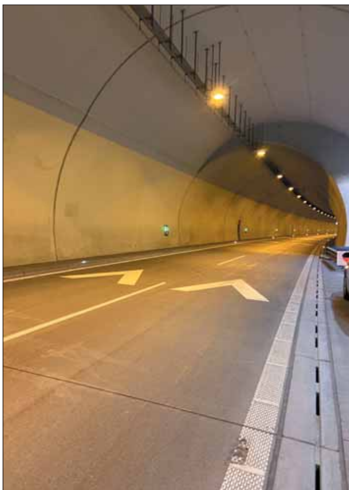
Obr. 1 Tunel Považský Chlmec s CB krytom vozovky Fig. 1 Považský Chlmec tunnel with cement concrete pavement
