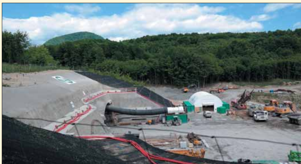
Obr. 11 Pohľad na východný portál tunela Okruhliak Fig. 11 View of the eastern portal of the Okruhliak Tunnel
