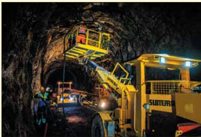
Obr. 10 Instalace primárních liniových a plošných svodnic (Dolenco) pro svedení průsaků vody na skalním líci před aplikací stříkaného betonu
