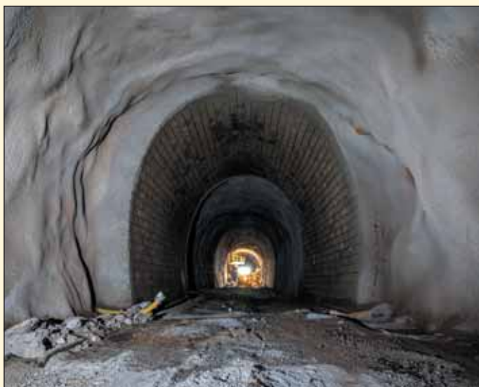
Obr. 8 Přechod mezi podkladní vrstvou stříkaného betonu a stávající kamennou obezdívkou
