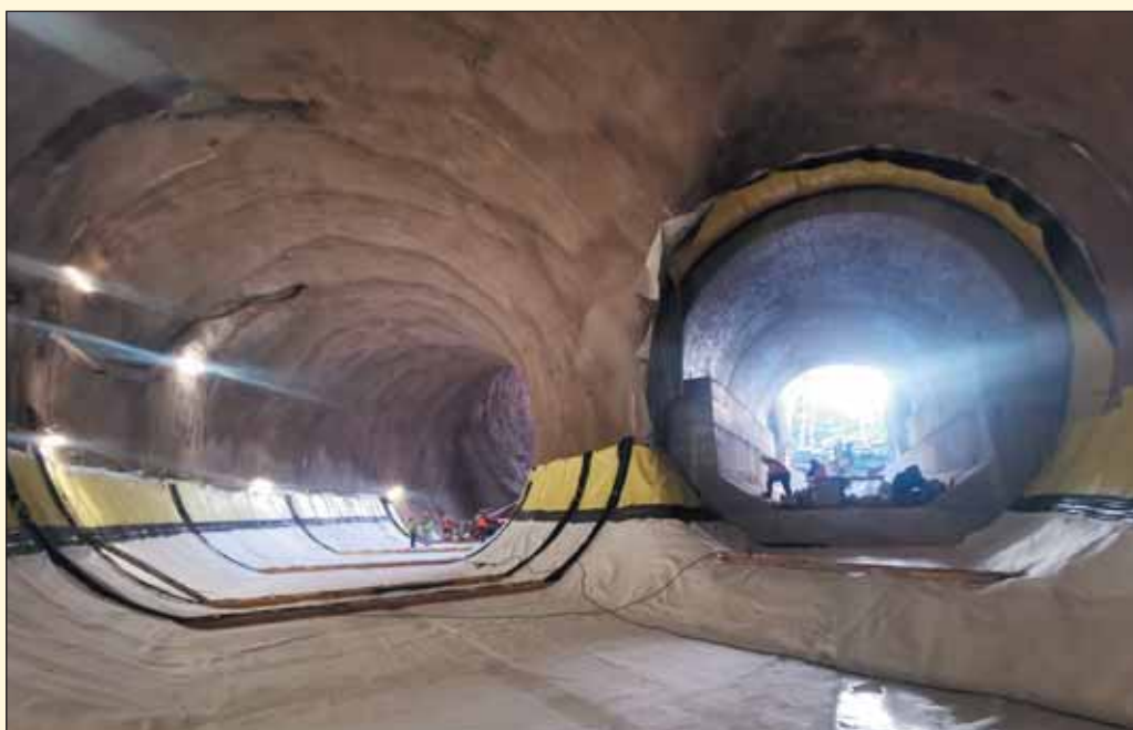
Obr. 3 Pohled na provádění izolace a definitivního ostění eskalátorového a staničního tunelu stanice Fig. 3 View of executed waterproofing and final lining of the escalator and station tunnel of the station
