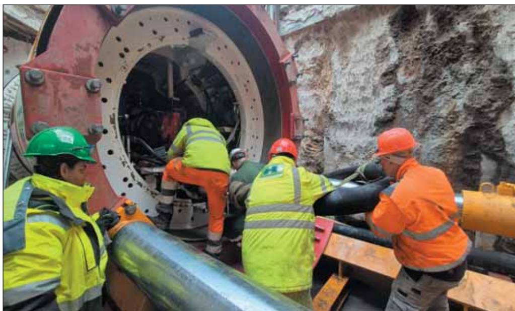
Obr. 3 Přepojování potrubí po vložení druhé části stroje Fig. 3 Reconnecting of pipes after inserting the second part of the machine
