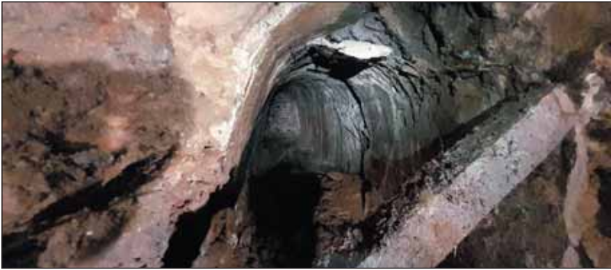
Obr. 2 Havarovaná původní odvodňovací štola X. Fig. 2 Wrecked original X. drainage gallery
