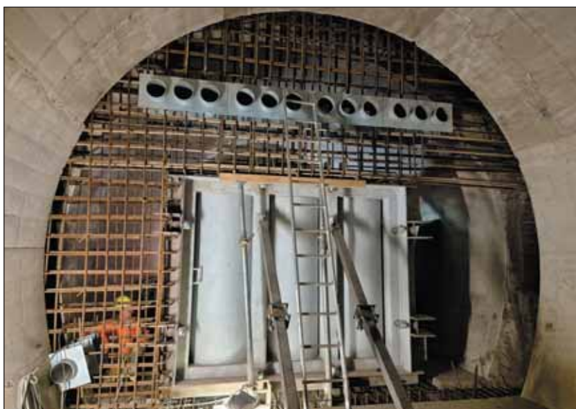
Obr. 10 Osazení tlakového uzávěru v přestupní chodbě Fig. 10 Installation of the pressure seal in the transfer corridor
