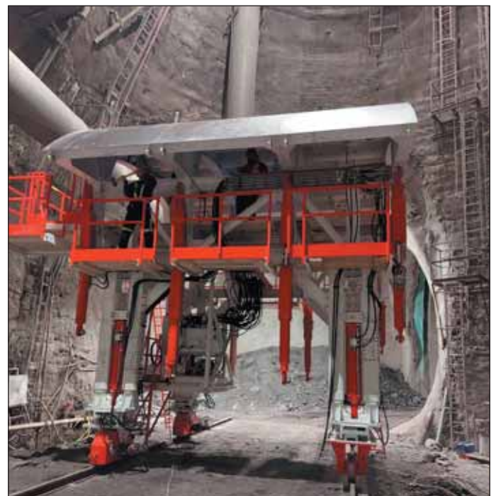
Obr. 6 Montáž bednicího vozu v prostoru propojky sever pod šachtou pro výstavbu stanice Fig. 6 Assembly of the form traveller in the area of the northern cross passage beneath a shaft for the construction of the station
