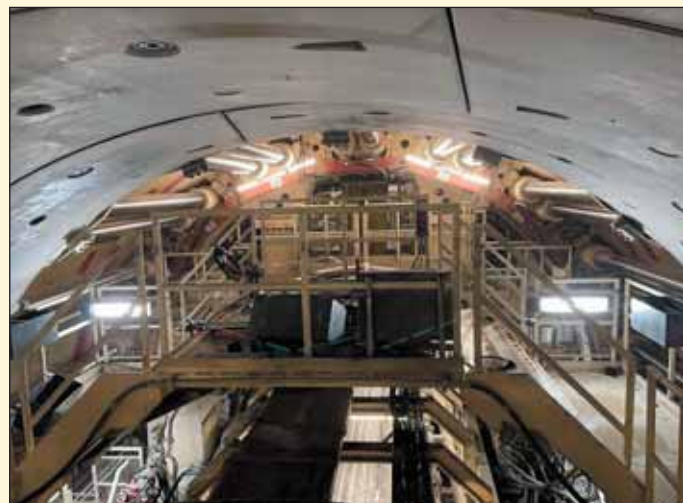
Obr. 4 Použitý stroj TBM na ZS H53 v rámci projektu Brenner Base Tunnel Fig. 4 Used TBM machine on ZS H53 within the Brenner Base Tunnel project
