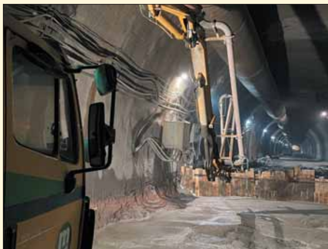
Obr. 5 Betonáž spodnej klenby v tuneli Okruhliak Fig. 5 Invert concrete casting in the Okruhliak tunnel
