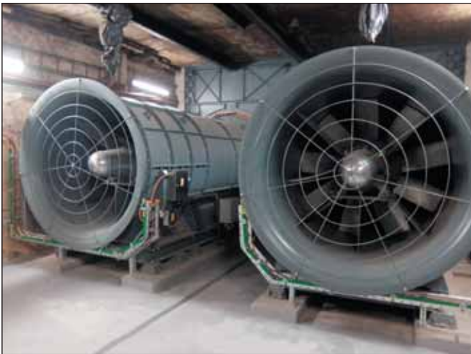
Obr. 2 Strojovna hlavního větrání metro I.C Vrchlického v traťovém úseku po rekonstrukci s ventilátory APWM 1800
