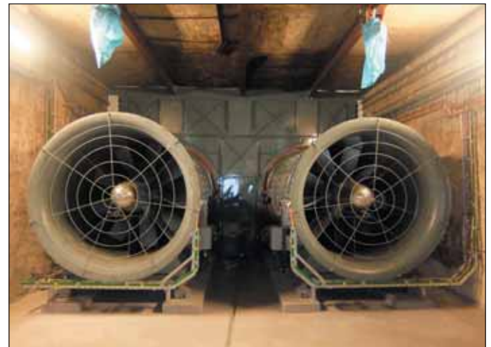
Obr. 3 Strojovna hlavního větrání metro I.C stanice Muzeum po rekonstrukci s ventilátory APWM 1800
