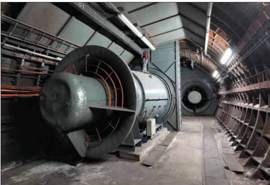
Obr. 4 Strojovna hlavního větrání metro II.B stanice Křížkova se stávajícími ventilátory APE 1800
