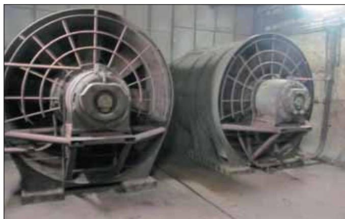
Obr. 1 Strojovna hlavního větrání metra I.C Vrchlického v traťovém úseku s původními ventilátory APE 1800
