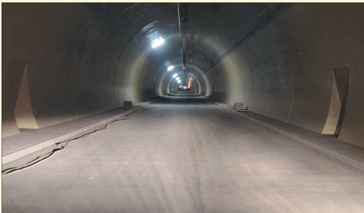
Obr. 4 Južná tunelová rúra tunela Čebrať – dokončené sekundárne ostenie vrátane vozovky a náterov
