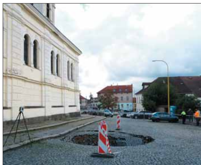
Obr. 3 Propad náměstí na Březových Horách průměru 6,0 m způsobený středověkou šachtou Fig. 3 Inbreak of the square in Březové Hory 6.0m in diameter caused by a medieval shaft
