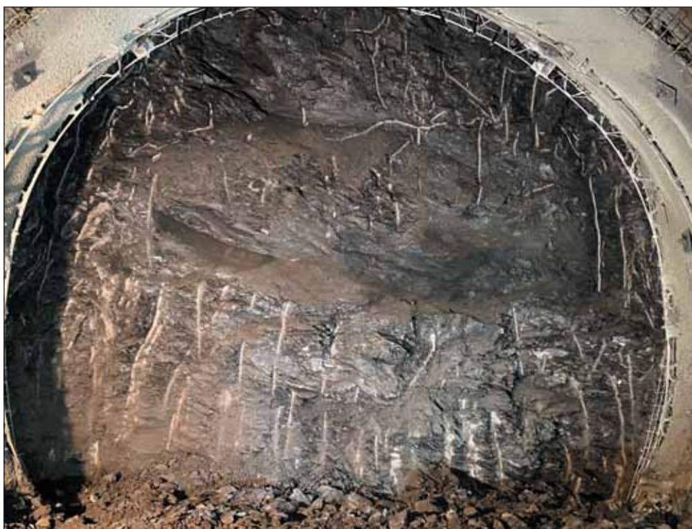
Obr. 5 Břidlice bohdaleckého souvrství se silným tektonickým porušením na čelbě levého jednokolejného tunelu Fig. 5 Bohdalec formation shale with heavy tectonic faulting at the heading of the left-hand single-track tunnel
