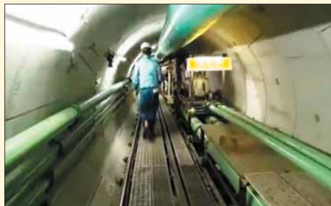
Obr. 4 Štola pro vypouštění upravené chladicí vody do moře Fig. 4 Gallery for discharging treated cooling water into the sea
