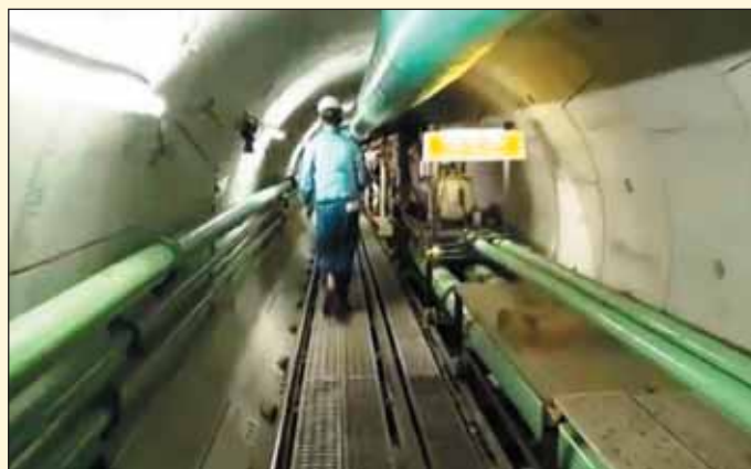
Obr. 4 Štola pro vypouštění upravené chladicí vody do moře Fig. 4 Gallery for discharging treated cooling water into the sea
