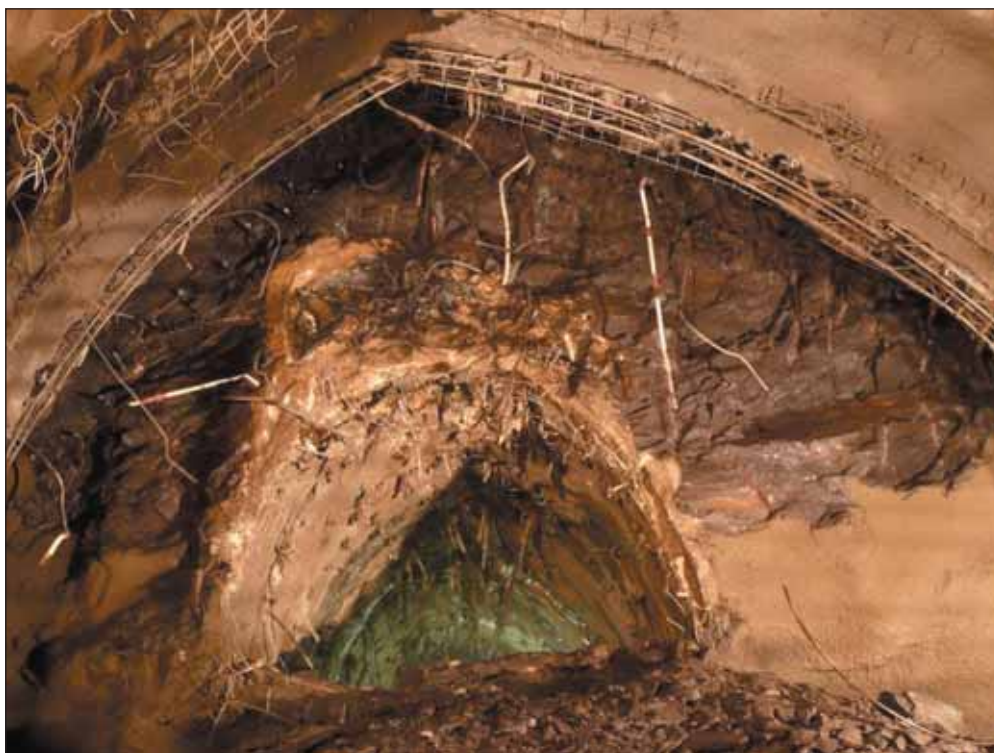
Obr. 2 Celkový pohled na kalotu čelby po odtěžení horniny (lokality Královská obora, TKB)
