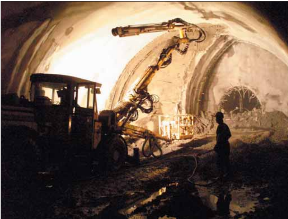
Obr. 4 Vrtací práce pro realizaci zpevňujících injektáží na členěné kalotě raženého tunelu (lokality Královská obora, TKB)
