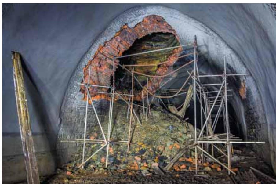
Obr. 2 Kolaps tunelového ostění v místě větrací šachty Fig. 2 Collapse of the tunnel lining in ventilation shaft mouth
