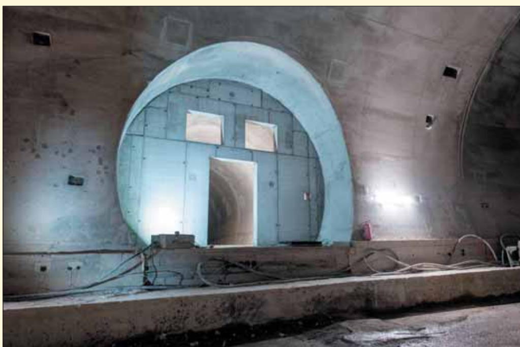
Obr. 5 Oddelujúca stena na vchode do priečného priečného prepojenia v tuneli Višňové Fig. 5 Dividing wall at the entrance to a cross passage passable for persons in the Višňové tunnel
