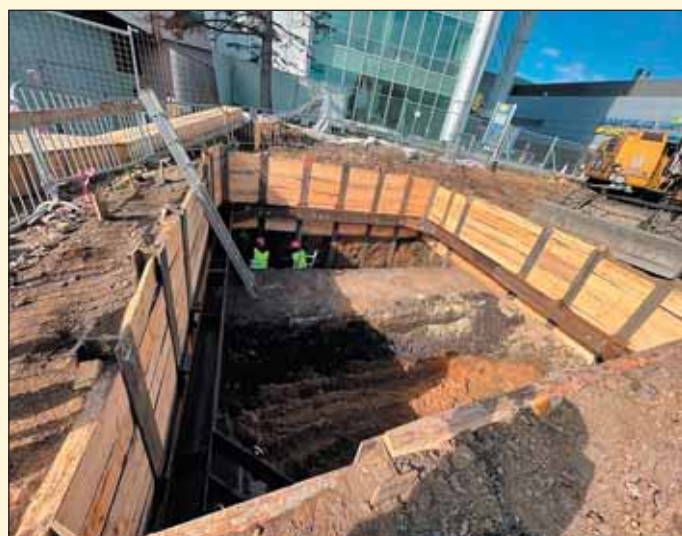
Obr. 3 Realizace šachty Š3 pro provádění aktivačních injektáží do podloží budov zastřežených ražbou Fig. 3 Work on shaft Š3 for activation grouting into foundation bed of buildings affected by excavation
