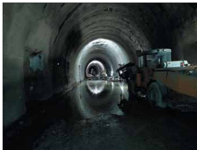
Obr. 9 Zatopený tunel po havárii Březovského vodovodu
