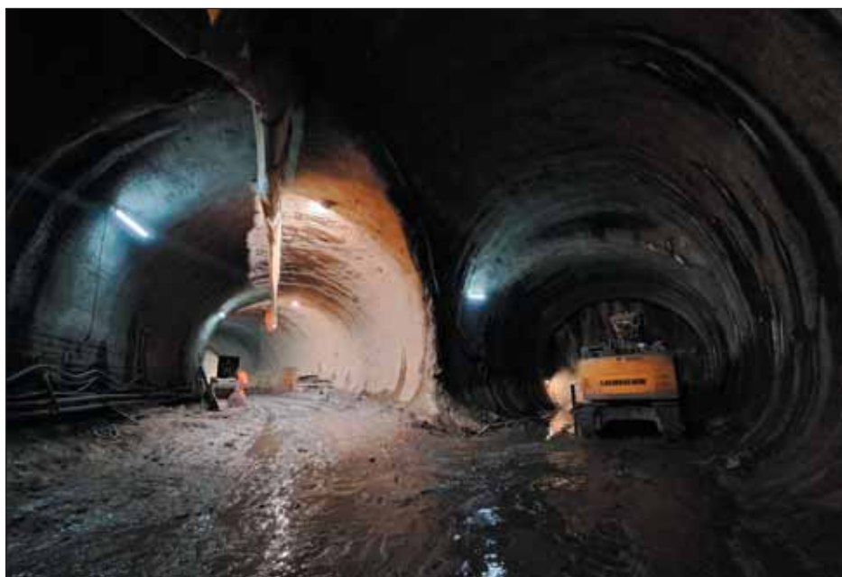
Obr. 3 Pohled do strojovny VZT (vlevo) a přístupové a VZT štol (vpravo) Fig. 3 View into HVAC tunnel (left) and into the access and ventilation adit (right)
