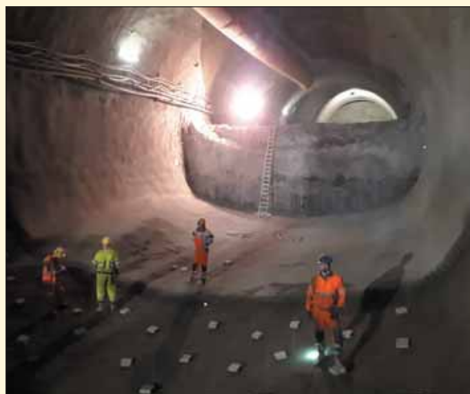
Obr. 7 Budovanie protiklenby vo vstrojovacej triede VT 7 v tuneli Čebrať Fig. 7 Construction of invert in excavation support class No. 7 in Čebrať tunnel
