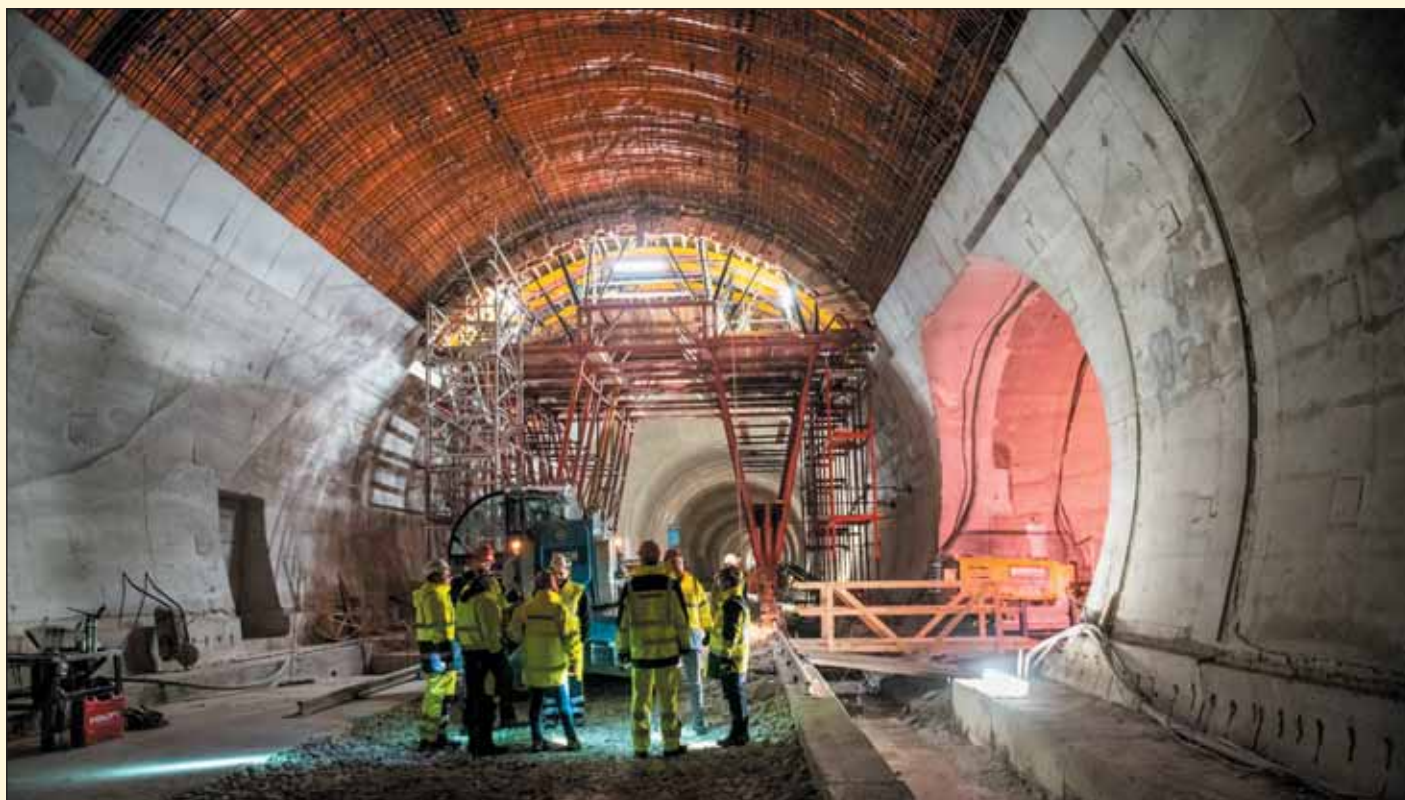
Obr. 8 Realizácia sekundárneho ostenia núdzového zálivu v tuneli Višňové Fig. 8 Work on secondary lining of emergency lay-by in Višňové tunnel
