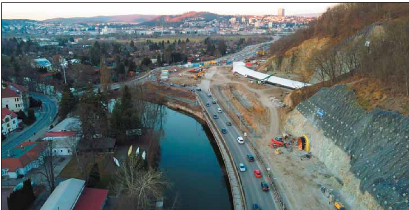
Obr. 2 Pohled na severní hloubenou část a portál únikové štoly Fig. 2 View of the southern cut-and-cover part and the portal of the escape adit
