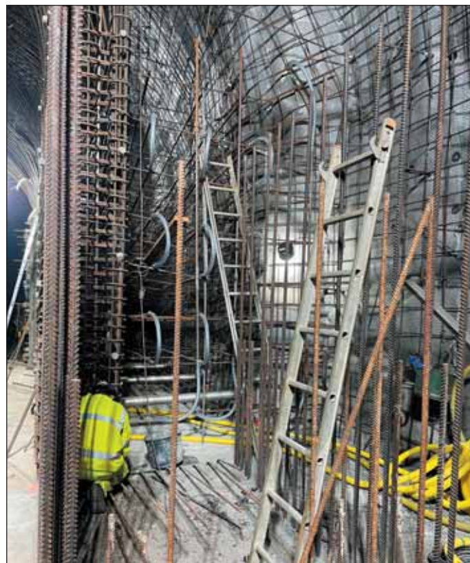
Obr. 8 Systém chlazení stěny tunelového ostění
