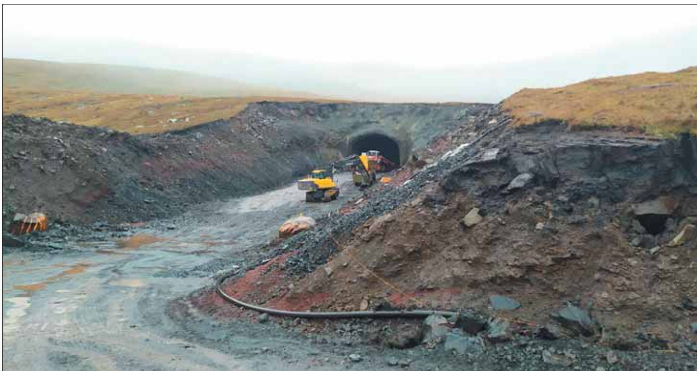
Obr. 10 Pohled na budoucí portál tunelu Ørðavík Fig. 10 View of the future Ørðavík tunnel portal
