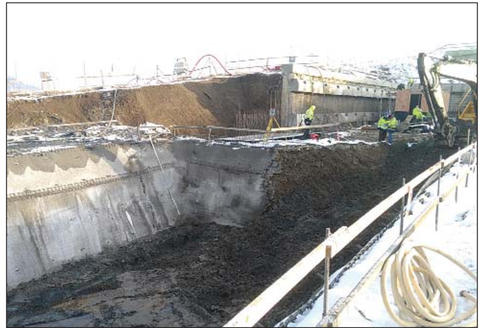
Obr. 8 Kľincovaný svah stavebnej jamy pre havarijnú akumulčnú nádrž Fig. 8 Slope of construction pit for emergency retention basin stabilised with nails
