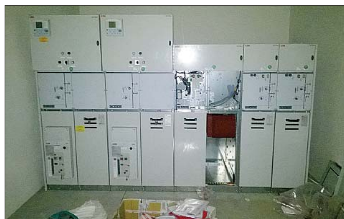
Obr. 2 Montáž rozvádzača VN v rozvodni Fig. 2 Installation of a HV switchboard in a substation
