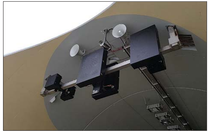
Obr. 10 Premenné dopravné značenie na východnom portáli tunela Svrčinovec Fig. 10 Variable message signs at the eastern portal of the Svrčinovec tunnel
