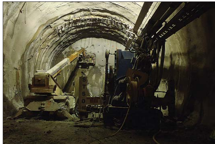
Obr. 2 Raziace a vystrojovacie práce v tunelových rúrach prebiehajú od oboch portálov Fig. 2 Tunnel excavation and installation of excavation support in tunnel tubes proceeding from both portals
