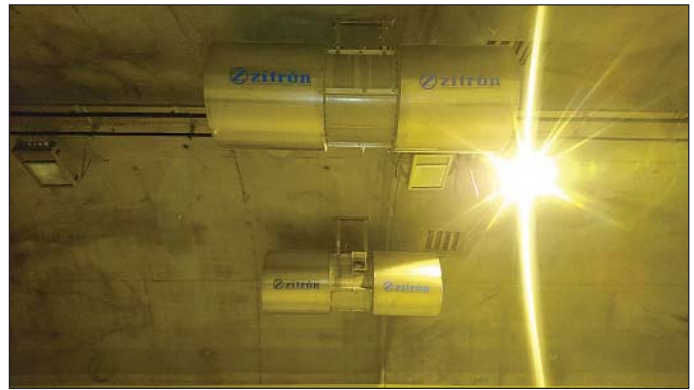
Obr. 8 Bočný pohľad na ventilátory tunela Poľana Fig. 8 A side view of fans in the Poľana tunnel
