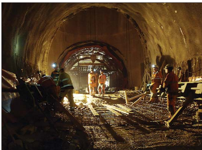
Obr. 5 Príprava betonáže spodnej klenby vetracieho kanálu v mieste vetracej šachty Fig. 5 Preparation for concreting the invert of the ventilation duct at the ventilation shaft
