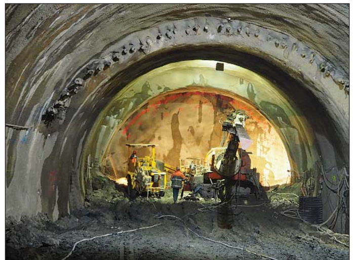
Obr. 4 Pohľad na mikropilótový dáždnik a vrtanie čelbových kotiev Fig. 4 A view of the canopy tube pre-support and drilling for anchors into excavation face
