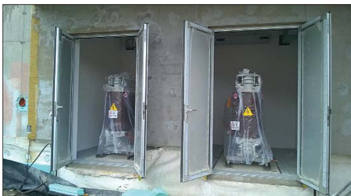
Obr. 3 Transformátory 630 kVA umiestené v PTO Fig. 3 Transformers 630kVA installed in the OTB
