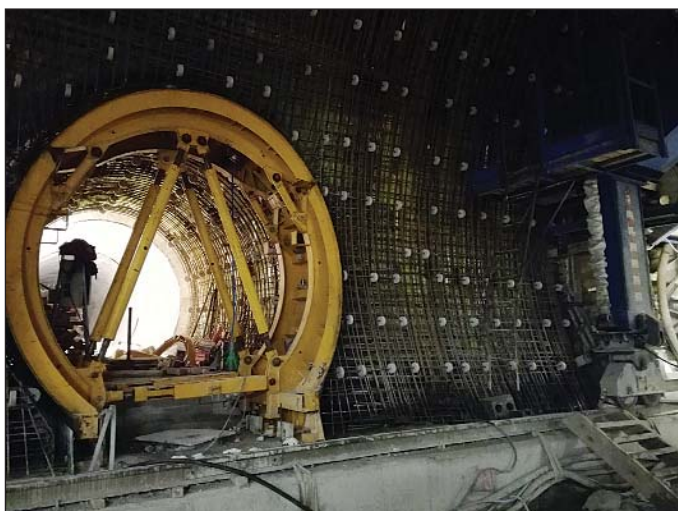
Obr. 7 Pohľad na vystužovanie priečneho prepojenia Fig. 7 A view of a cross passage being reinforced
