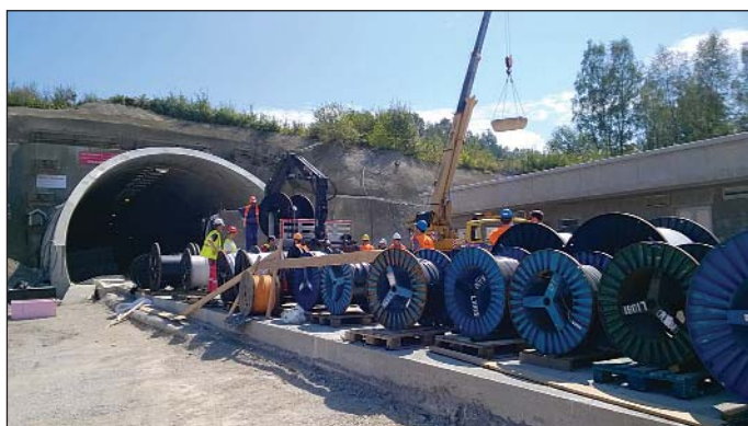
Obr. 1 Príprava pre montáž káblov v tuneli Poľana Fig. 1 Preparation for the installation of cables in the Poľana tunnel
