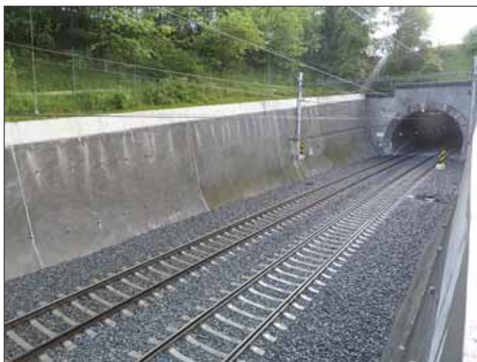
Obr. 2 Portál tunelu a zárubní zdi, pohled ze slovenské strany Fig. 2 Tunnel portal and revetment walls, viewed from the Slovak side
