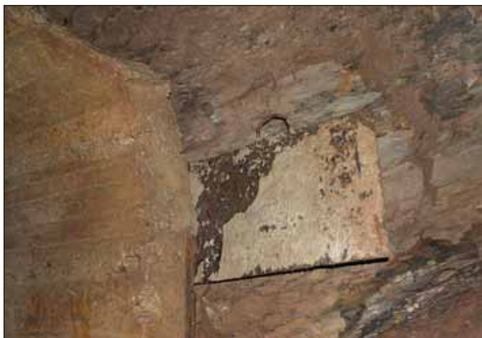
Obr. 7 Bednicí plech v podzemí tvrže Dobrošov Fig. 7 The steel sheet used for formwork in the Dobrošov fortress underground
