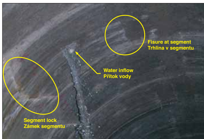
Obr. 14 Trhлина v segmentu ostění Fig. 14 A crack in a lining segment
