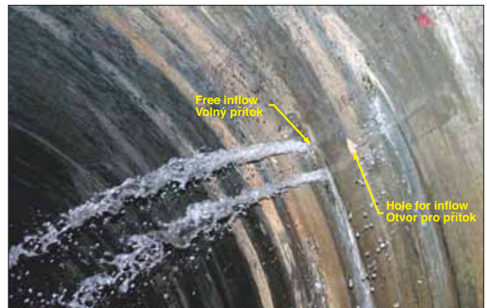
Obr. 13 Přítok vody do tunelu
