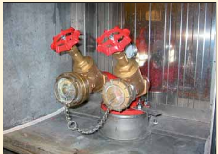
Obr. 11 Hydrantová nika s koncovkami pro napojení dánské a švédské požární techniky Fig. 11 A hydrant niche with terminals allowing the connection of both Danish and Sweden fire equipment
