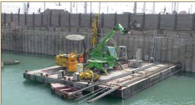
Obr. 4 Instalace kotev před podvodní betonáží betonového dna stavební jámy Fig. 4 Installation of anchors prior to the casting of the concrete bottom of the construction trench
