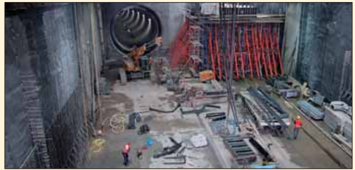
Obr. 3 Vpravo konstrukce tlakové komory pro průnik štítu do stavební jámy Fig. 3 For the left – the pressure chamber for the TBM breakthrough to the construction trench
