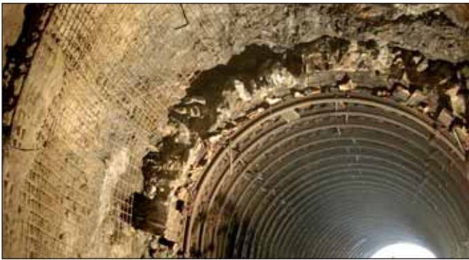
Obr. 5 Detail pobírání skalního masivu a původní obezdívky Fig. 5 A detail of the breaking of the rock and the original masonry lining
