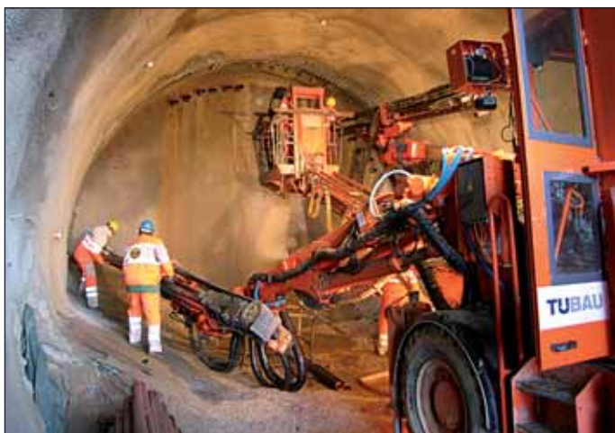
Obr. 4 Vrtanie mikropilotového dáždnika v tuneli Fig. 4 Drilling for the canopy tube pre-support in the tunnel
