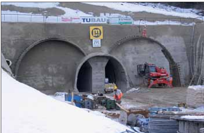
Obr. 3 Pohľad na východný portál tunela Fig. 3 View of the eastern portal of the tunnel
