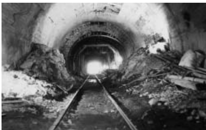
Obr. 5 Tunel Blanenský IV po odstranění závalu Fig. 5 The Blansko IV tunnel after the collapse removal
