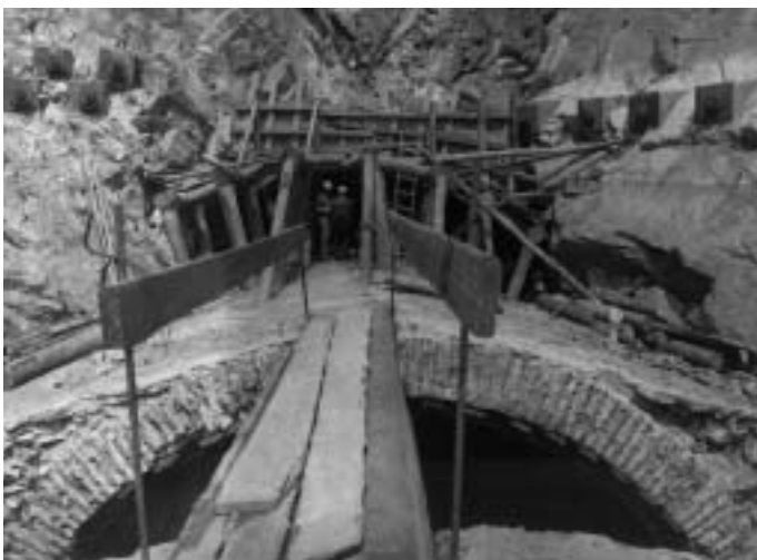
Obr. 6 Přestavba tunelu klasickým způsobem Fig. 6 A tunnel reconstruction using a conventional method
