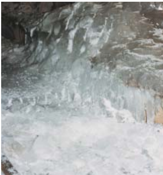
Obr. 2 Zaledování Ještědského tunelu Fig. 2 The Ještěd tunnel filled with ice
