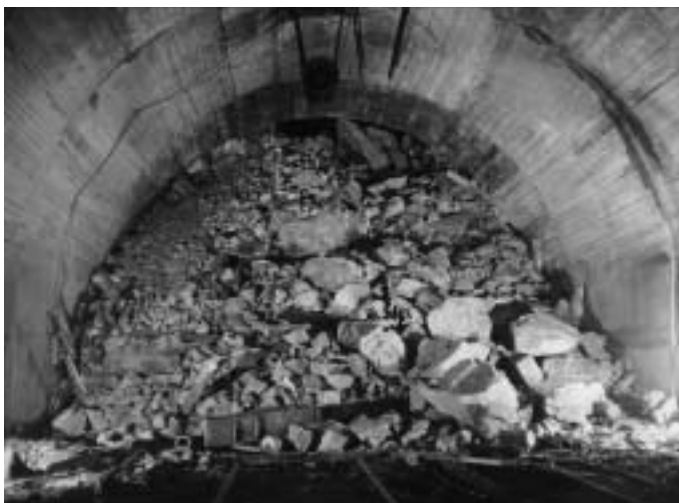
Obr. 7 Zával na tunelu Blanenském IV Fig. 7 The Blansko IV tunnel collapse
