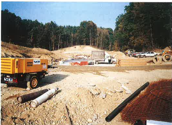
Obr. 1 Celkový pohľad na stavenisko od južného portálu Fig. 1 Overall view of the site from the south portal
