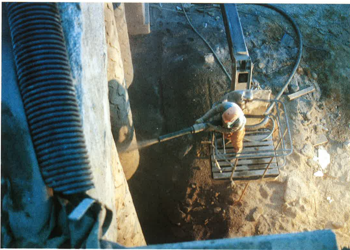
Obr. 5 Aplikácia striekaného betónu na pilleroch portálu Fig. 5 Application of shotcrete on the portal pillars
