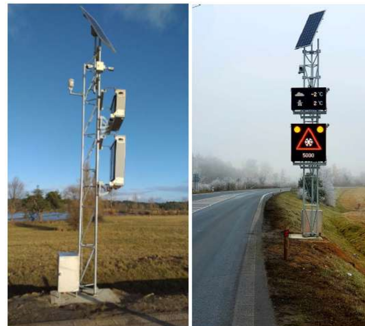
Kombinovaná meteorologická stanice a stanice dopravního značení (zdroj: ELTODO)
