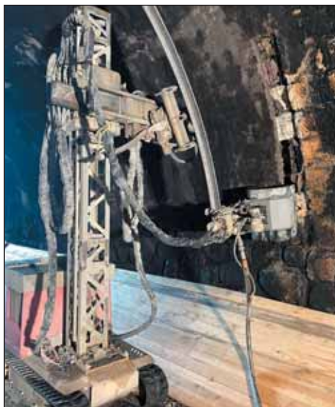
Obr. 4 Odstránenie starého torkrétového nástreku z ostenia tunela hydrodemolačným robotom Aquacutter 710 V Fig. 4 Removal of old shotcrete from the tunnel lining with the hydrodemolition robot Aquacutter 710 V
