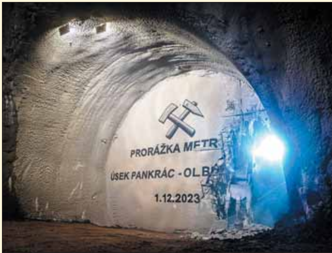
Obr. 1 Slavnostní prorážka úseku Pankrác – Olbrachtova dne 1. 12. 2023 Fig. 1 Ceremonial breakthrough of Pankrác – Olbrachtova section on 1/12/2023
