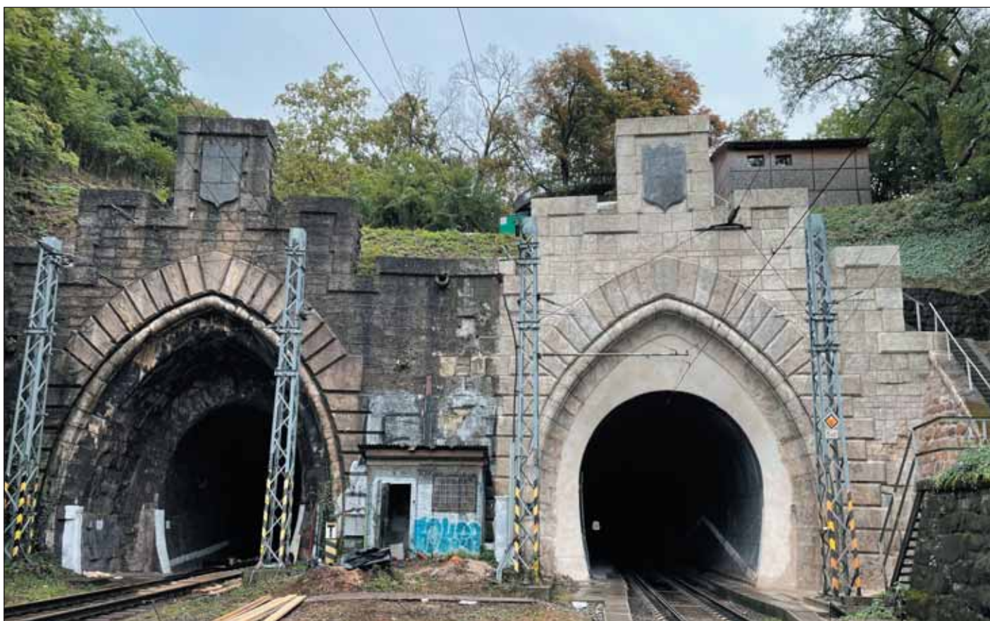
Obr. 3 Obnovená plocha portálu P1 v okolí Bratislavského tunela č. 1 po výluke N1
