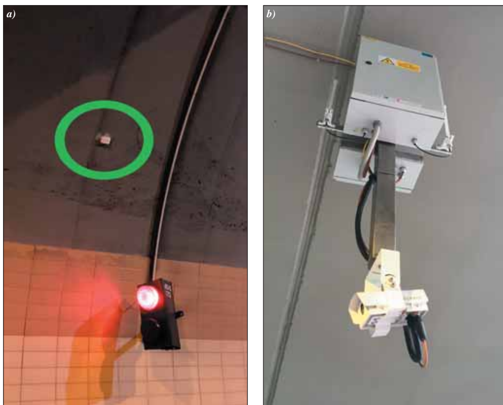
Obr. 2 a) Umístění beaconu na ostění v tunelu Mrázovka; b) Umístění RSU v tunelu Hřebeč Fig. 2 a) Position of a beacon on the lining of the Mrázovka tunnel, b) RSU position in Hřebeč tunnel
