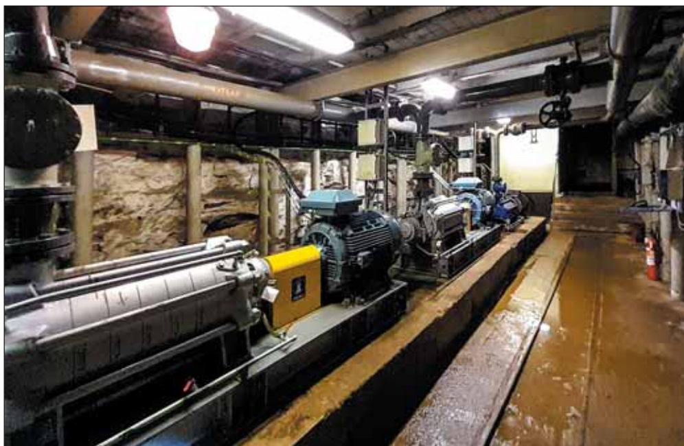
Obr. 7 Čerpadla Sigma 125-CVN-350 v hlavní čerpací stanici na 12. patře jámy R1 Fig. 7 Sigma 125-CVN-350 pumps in the main pumping station on the 12 th level of shaft R1
