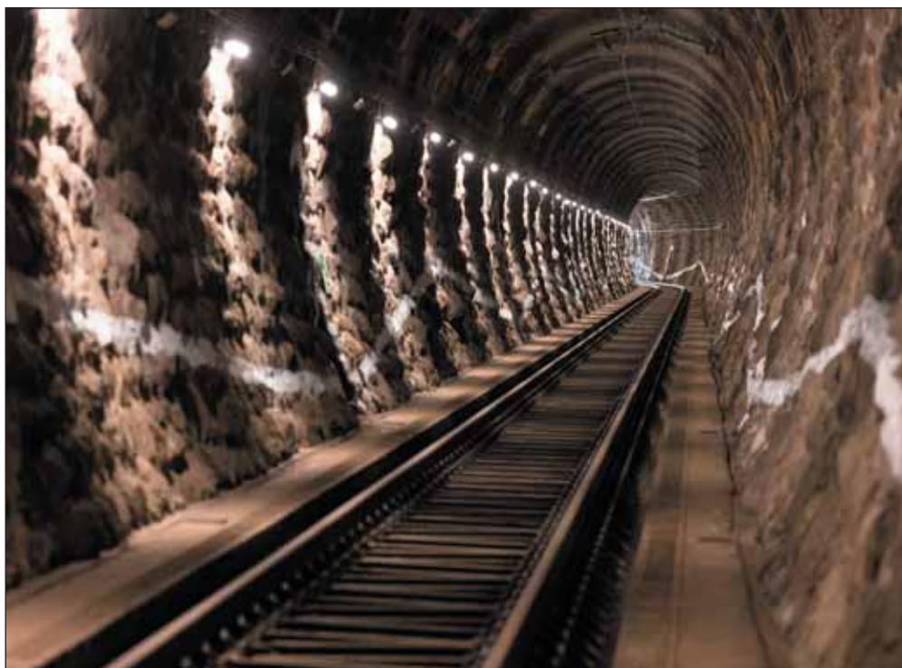
Obr. 10 Bratislavský tunel č. 2 po ukončených rekonštrukčných prácach Fig. 10 Bratislava tunnel no. 2 after the completed reconstruction works
