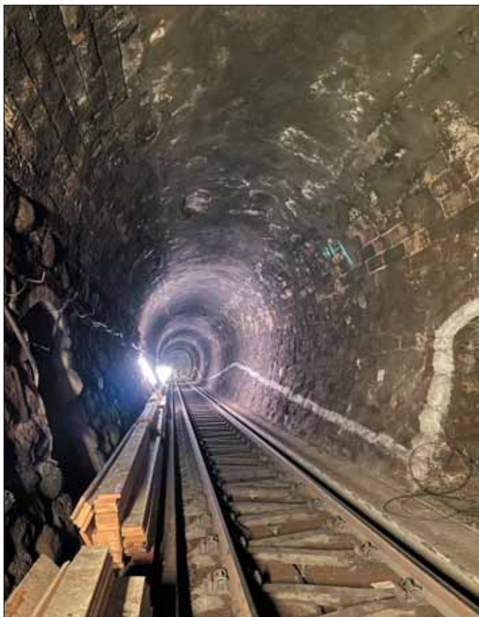
Obr. 2 Stav Bratislavského tunela č. 2 pred rekonštrukciou Fig. 2 Condition of the Bratislava tunnel no. 2 before reconstruction
