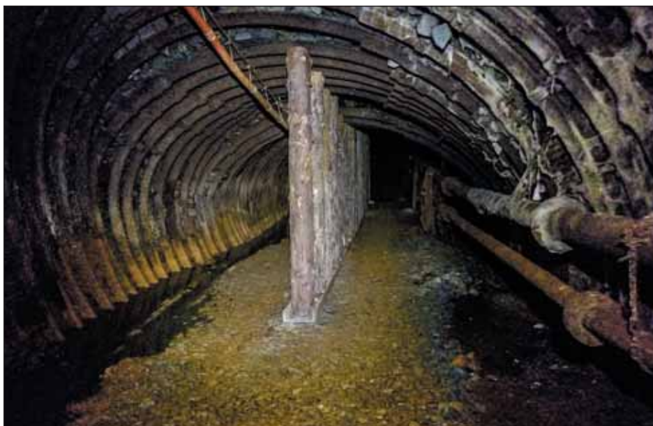
Obr. 7 Podpěrná dřevěná výztuž zbudovaná v místě zatlačení ocelové obloukové výztuže Fig. 7 Timber support of excavation erected in the location of steel arch support pressing into ground
