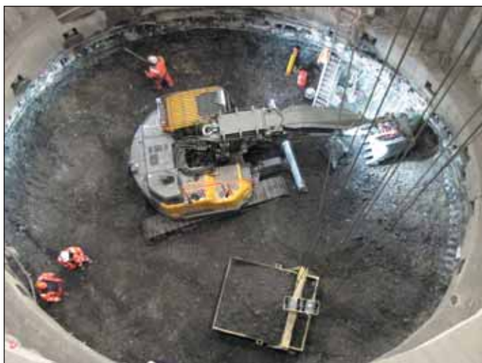
Obr. 6 Hloubení šachty stanice Olbrachtova v poruchové zóně Fig. 6 Sinking of Olbrachtova station shaft in fault zone
