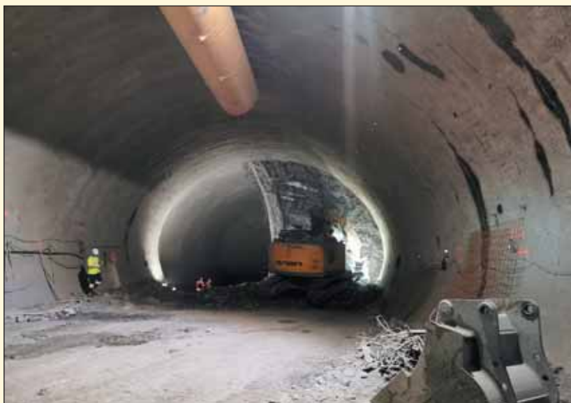
Obr. 1 Pohled na ražby obrátových kolejí stanice Pankrác Fig. 1 A view of excavation for turn-back tracks of Pankrác station
