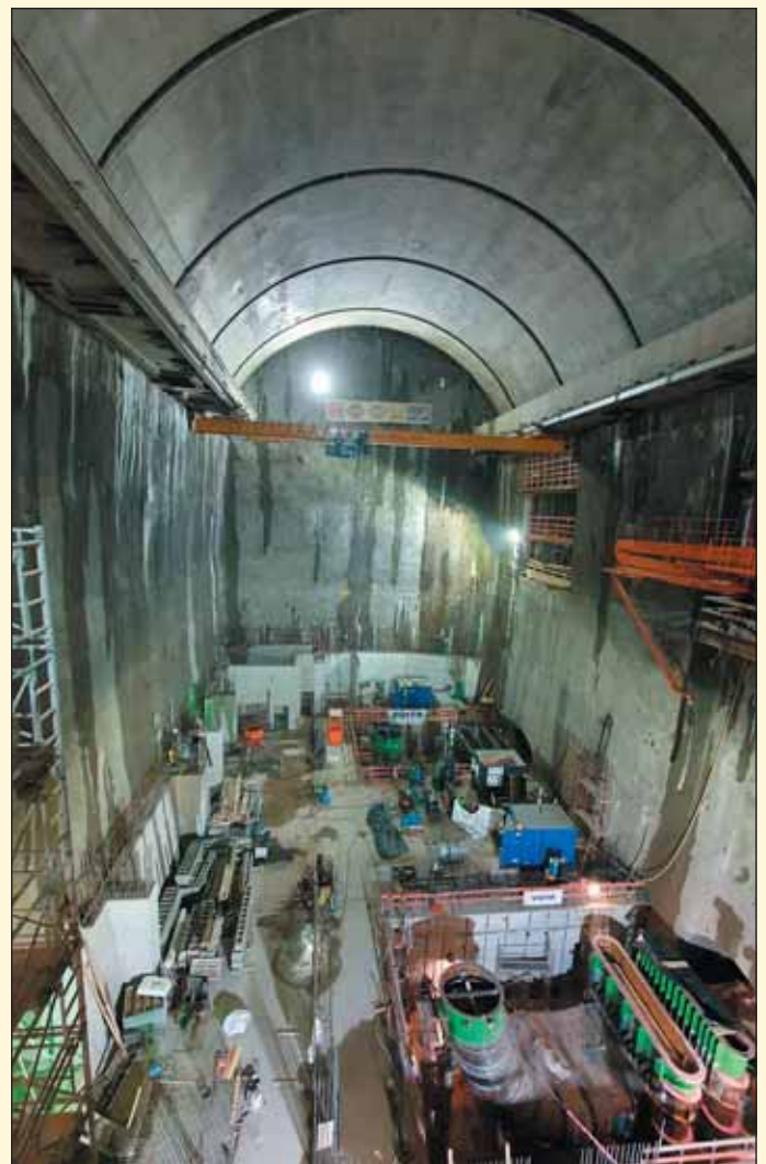
Obr. 3 Kaverna strojovny s již osazenými turbínami Fig. 3 Transformer room cavern with turbines already installed
