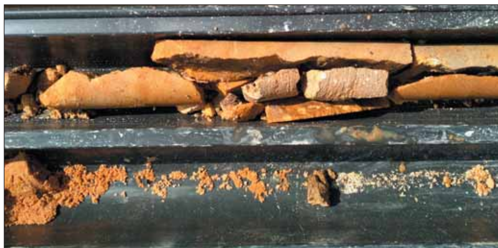
Obr. 1 Rozpad kamenné obezdívky – detail části sondy v TP12
