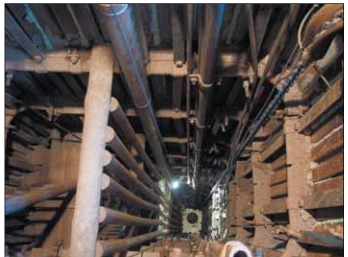
Obr. 9 Zmáhání staré šachty v propadu, stav po sanaci výztuže KŠ1 Fig. 9 Remediation of the old shaft in the collapsed area, situation after remediation of the KŠ1 support
