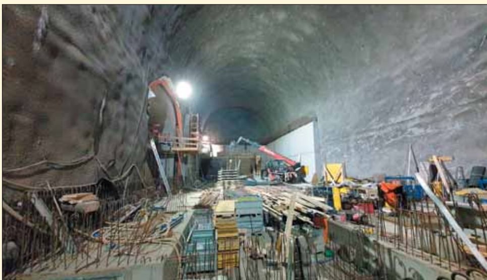
Obr. 4 Kaverna transformátorovny Fig. 4 Transformer room
