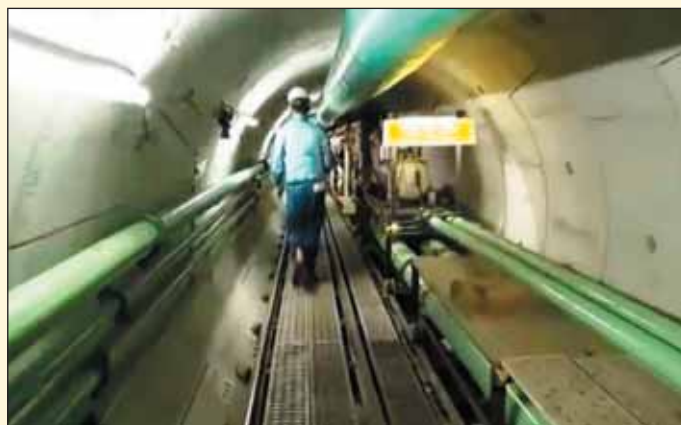
Obr. 4 Štola pro vypouštění upravené chladicí vody do moře
