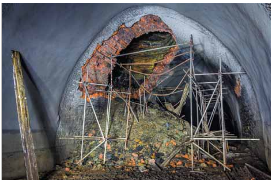
Obr. 2 Kolaps tunelového ostění v místě větrací šachty Fig. 2 Collapse of the tunnel lining in ventilation shaft mouth
