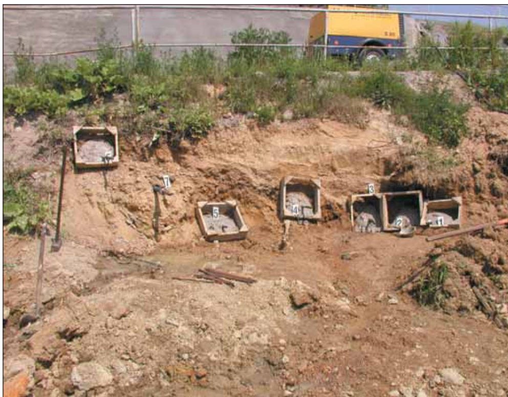
Obr. 6 Zkušební pole s injekčními vrti č. 1–7 ve vrstvě zvodněných štěrkopísků (lokality Brno, Královopolský tunel) Fig. 6 Test field with boreholes No. 1–7 in aquifered gravel sands (locality Brno, Královopolský tunnel)
