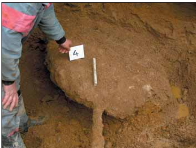
Obr. 7 Odtěžené těleso proinjektované zeminy – tzv. geokompozit (lokality Brno, Královopolský tunel) Fig. 7 Extracted body of grouted soil – so called geocomposite (locality Brno, Královopolský tunnel)
