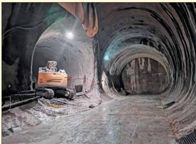
Obr. 1 Ražba rozrážky do vzduchotechnických tunelů stanice Pankrác Fig. 1 Excavation of a tunnel eye to Pankrác station ventilation tunnels
