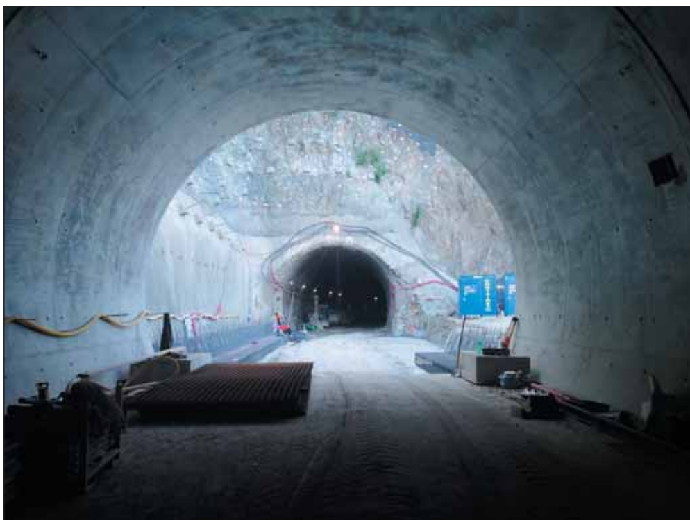
Obr. 6 Pracovní mezera mezi raženým a přesypávaným úsekem – pohled z přesypávaného tunelu Fig. 6 Working gap between the mined tunnel and false tunnel – viewed from the false tunnel
