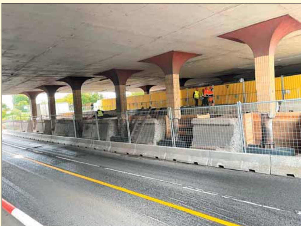
Obr. 1 Příprava pro preventivní zajištění mostní konstrukce z důvodu probíhajících ražeb Fig. 1 Preparation for preventative stabilisation of the bridge structure due to ongoing excavation
