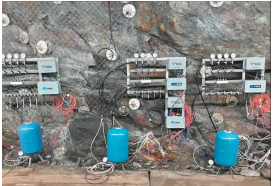
Obr. 9 Kontrolní a ovládací panely multipakrů ve vrtech v PVP Bukov
