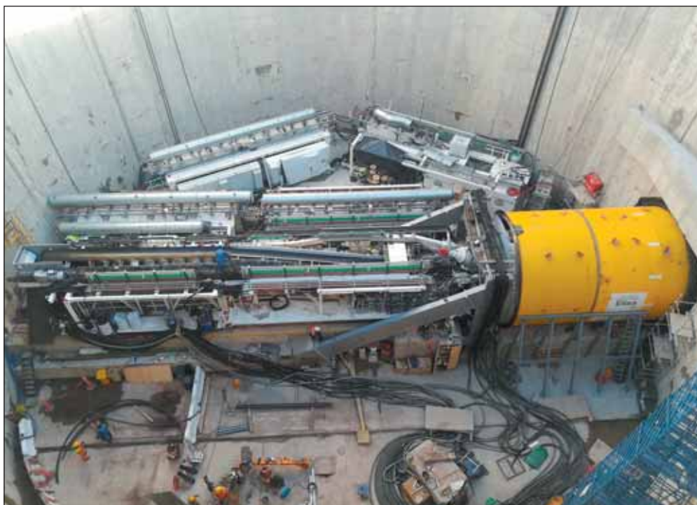
Obr. 3 EPB štít vo vnútri šachty so štartovacím rámom Fig. 3 EPB shield inside the shaft with launching frame
