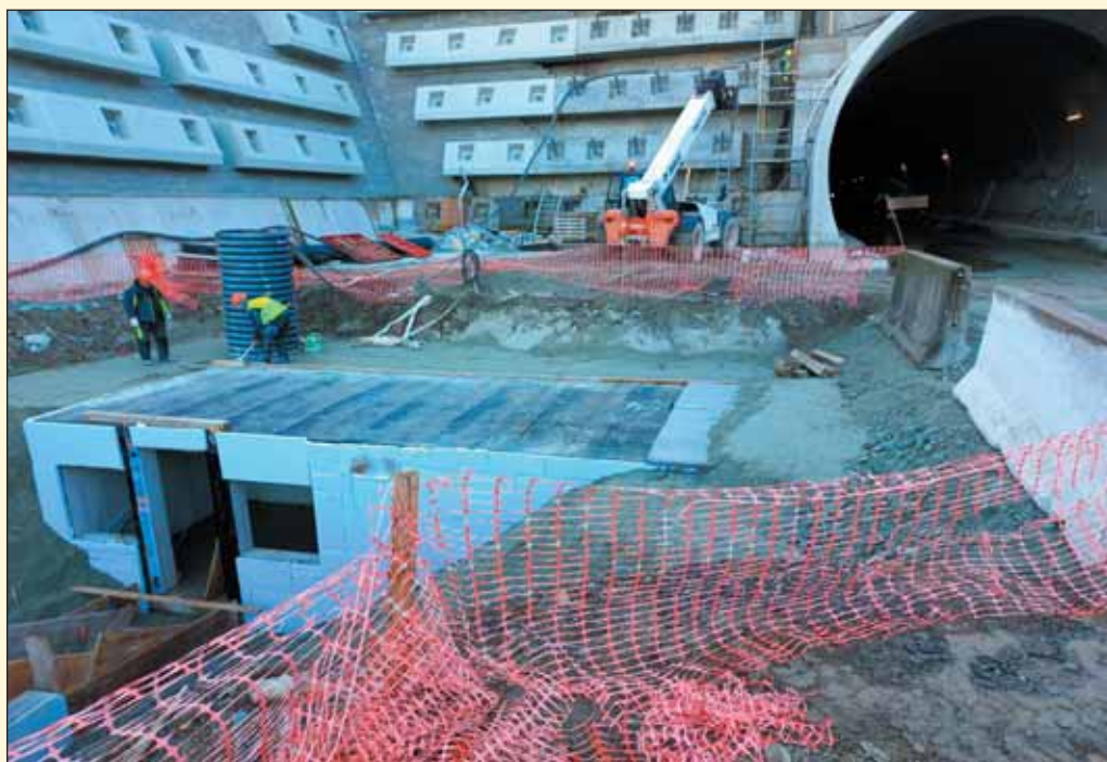
Obr. 8 Dokončovacie práce na zásype kolektora na západnom portáli tunela Višňové Fig. 8 Finishing work on the backfill of the utility tunnel at the western portal of the Višňové tunnel
