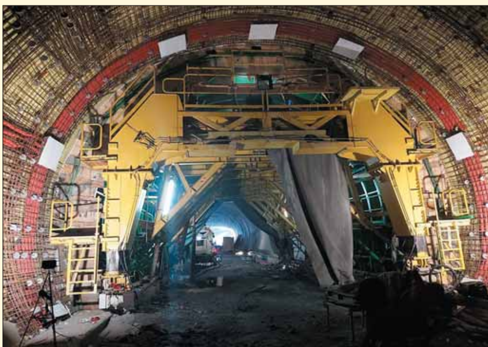
Obr. 6 Debniaci voz pre sekundárne ostenie v južnej tunelovej rúre tunela Čebrať Fig. 6 Tunnel form traveller for secondary lining in the southern tube of the Čebrať tunnel
