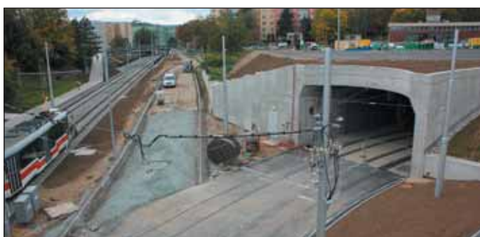
Obr. 1 Pohled na vjezdový (jižní) portál a přilehlé opěrné zdi, probíhají dokončovací práce a obnova místní komunikace Fig. 1 View of the entrance (southern) portal and adjacent retaining walls, finishing work and restoration of local road are underway
