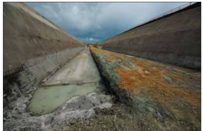
Obr. 4 Základová spára svahovaného úseku jámy Fig. 4 Foundation base of the section of the pit with slopes
