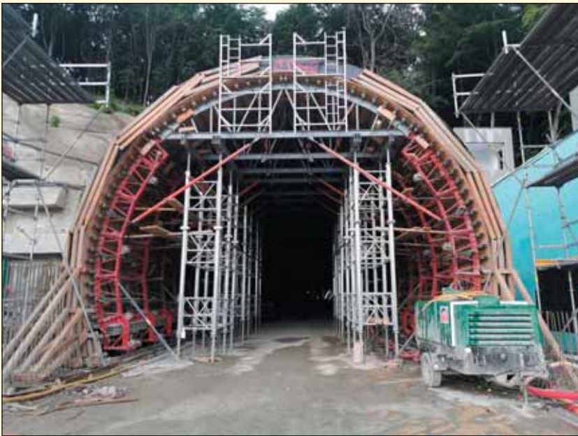
Obr. 5 Betonáž hĺbeného tunela na východnom portáli tunela Prešov Fig. 5 Concreting the cut-and-cover tunnel at the eastern portal of the Prešov tunnel
