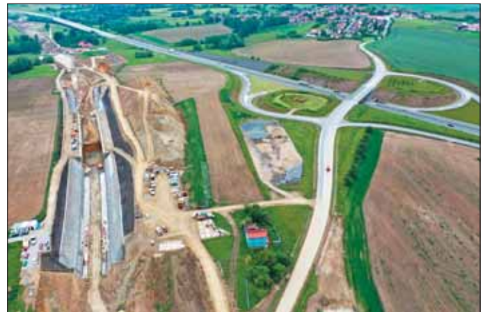
Obr. 6 Situování stavební jámy v blízkosti dálnice D3 Exit Soběslav Fig. 6 Location of the construction pit near the D3 motorway, Soběslav exit
