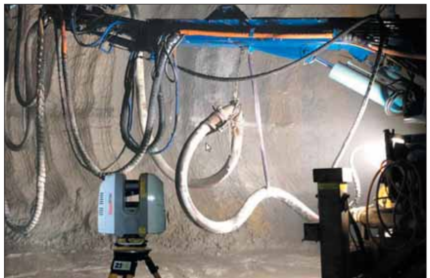
Obr. 3.2 Geotechnický monitoring LiDAR (GML)
