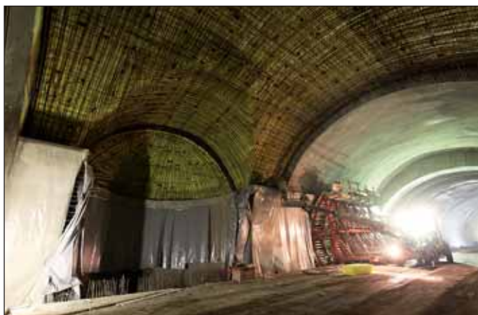
Obr. 4 Nadvýšený třípruhový tunel v místě napojení kanálu 04 před prováděním klenby Fig. 4 Enlarged-height triple-lane tunnel at the connection of duct 04 before the execution of the vault
