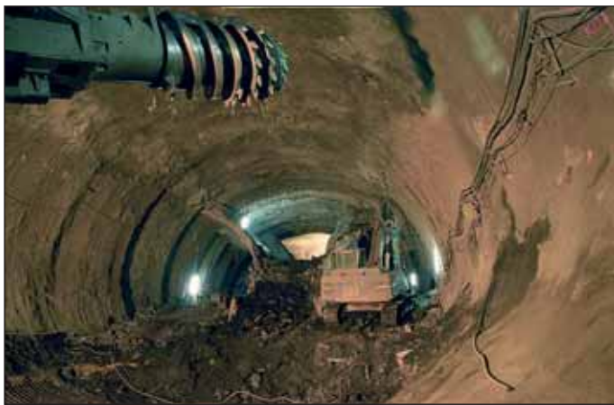
Obr. 5 Tunel Mrázovka (v provozu od r. 2004) – foto: Archiv IKP CE Fig. 5 Mrázovka tunnel (in operation from 2004) – photo IKP CE archive
