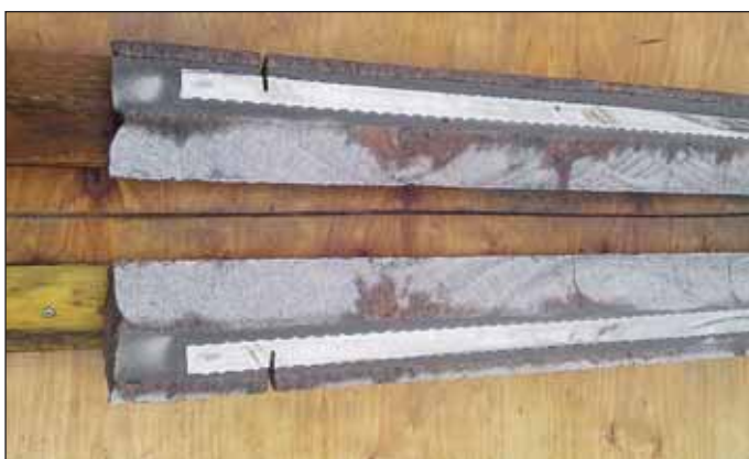
Obr. 10 Podélně rozříznutý svorník v jádrovém odvrtu
