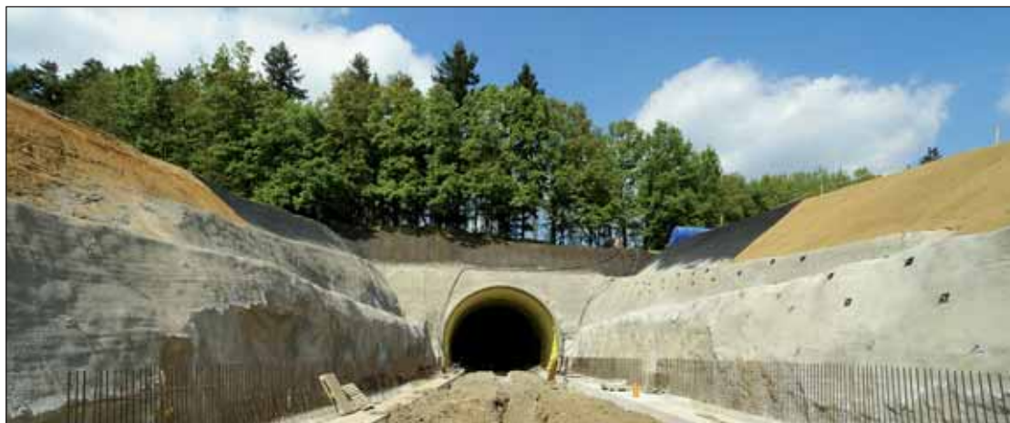
Obr. 19 Tunel Tomický I (v provozu od r. 2011) Fig. 19 Tomice I tunnel (in operation from r. 2011)
