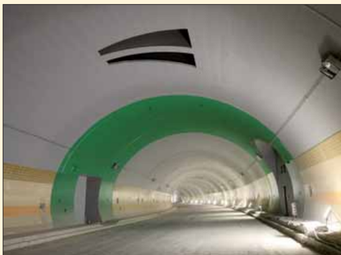
Třípruhový ražený tunel úseku Brusnice s dokončenými obklady stěn (foto: Jakub Karlíček)
