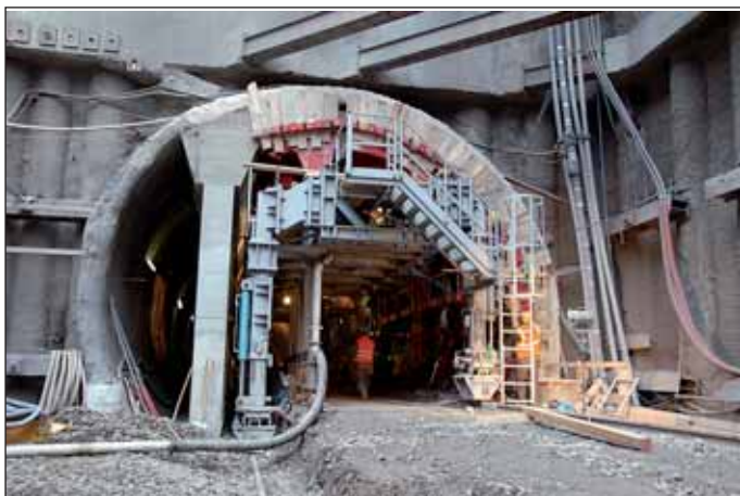
Obr. 2 Veleslavín – portál ražené trojlodní stanice Fig. 2 Veleslavín – portal of the mined triple-span station
