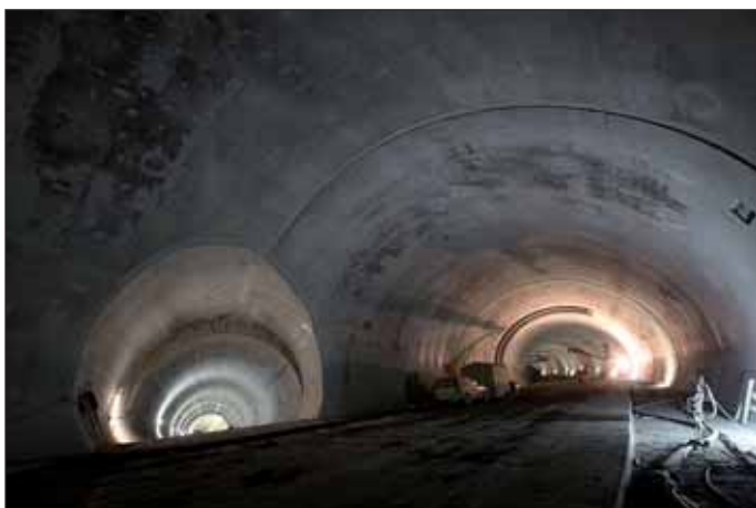
Obr. 14 Napojení kanálu 03 na severní třípruhový tunel Fig. 14 Connection of duct 03 to northern triple-lane tunnel
