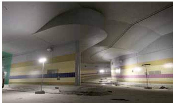
Obr. 2 Napojení výjezdové rampy na jižní hloubený tunel v křižovatce U Vorlíků, na obkladu jsou patrné charakteristické barvy tunelových úseků Dejvice a Královská obora (foto: Jakub Karlíček)
