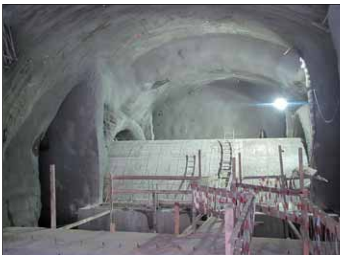
Obr. 14 Staveniště E1; v pozadí smontovaný tunel za EPBS Tonda Fig. 14 E1 site; assembled tunnel lining behind TBM Tonda in the background
