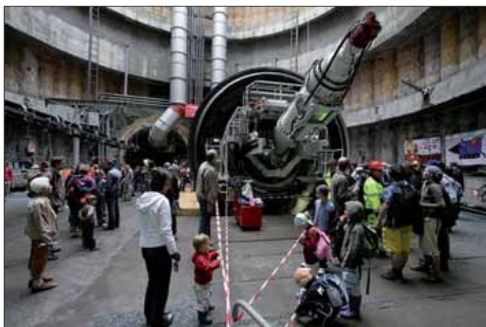
Obr. 9 Smontovaný EPBS S-610 Adéla při dnu otevřených dveří Fig. 9 Assembled TBM S-610 Adéla during "open door" day
