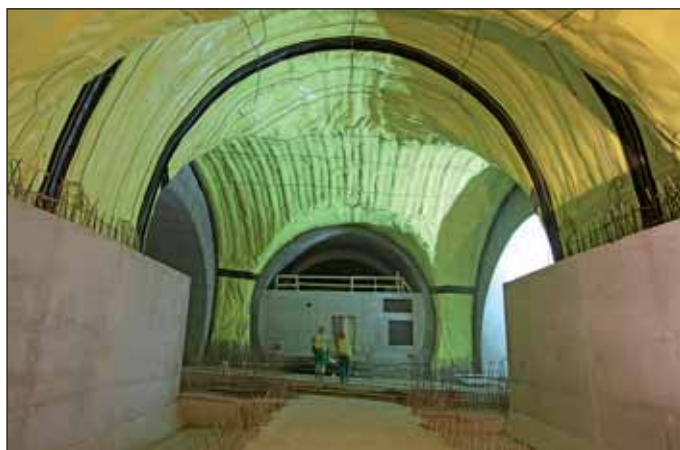
Obr. 11 Napojení TGC4 a propojky TP13 na třípruhový tunel Fig. 11 Connection of TGC4 services centre and TP13 cross passage to the triple-lane tunnel
