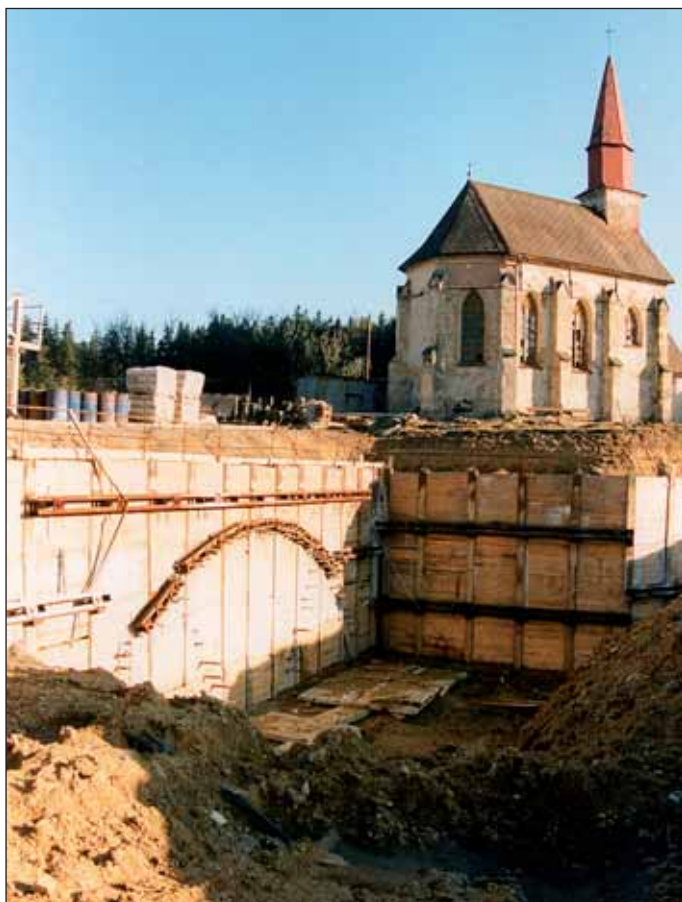
Obr. 1 Tunel Hřebeč (v provozu od r. 1997) Fig. 1 Hřebeč tunnel (in operation from 1997)
