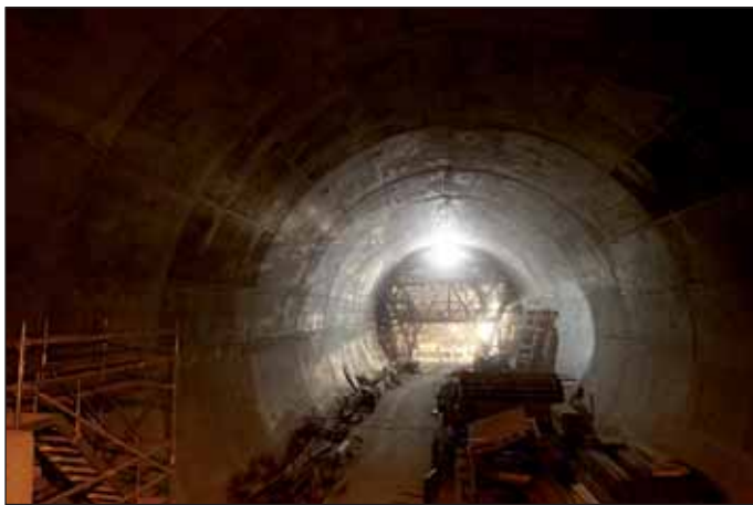
Obr. 19 Dokončené definitivní ostění strojovny VZT Fig. 19 Complete final lining of the ventilation plant cavern
