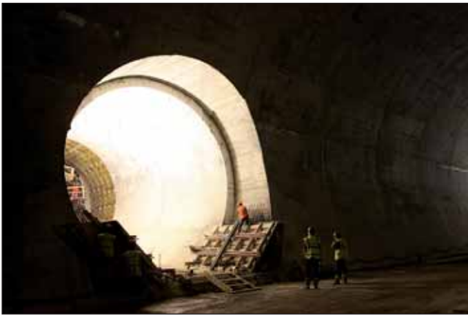
Obr. 18 Napojení kanálu 07 na strojovnu VZT bez dokončeného krčku Fig. 18 Connection of duct 07 to the ventilation plant cavern without the neck completed
