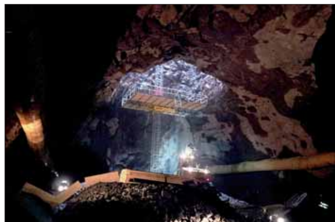
Obr. 5 Pracovní plošina v šachtě P 3.5 Fig. 5 Work platform in P 3.5 shaft
