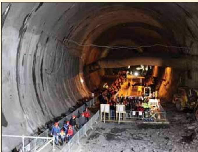
Obr. 1 Tunel Blanka – Den otevřených dveří: Pohled do strojovny vzduchotechniky Fig. 1 Community open day: A view into the ventilation plant cavern
