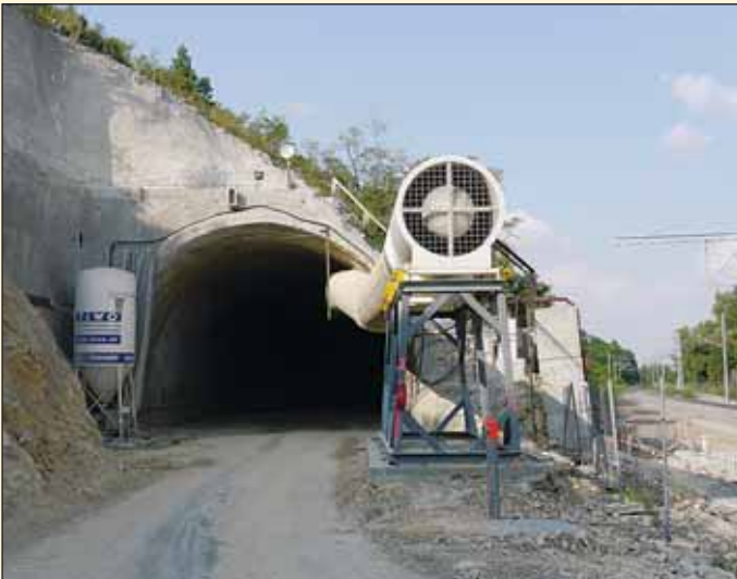
Obr. 1 Južný portál tunela Turecký vrch Fig. 1 Southern portal of the Turecký Hill tunnel
