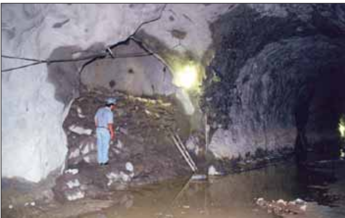
Obr. 19 Havárie opěrové části tunelu, který je součástí elektrárny Queimado v Brazílii Fig. 19 Breakdown of a sidewall part of a tunnel which is part of Queimado power plant in Brazil
