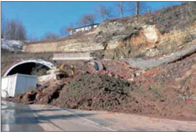
Obr. 21 Havárie portálové stěny v Hřebeči v dubnu 1995 Fig. 21 Collapse of a portal wall in Hřebeč, April 2006
